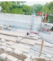
Risse: Hinter der Oberfläche kommen die wahren Schäden der Mauer zum Vorschein. Notabstützungen halten das Mauerwerk.
